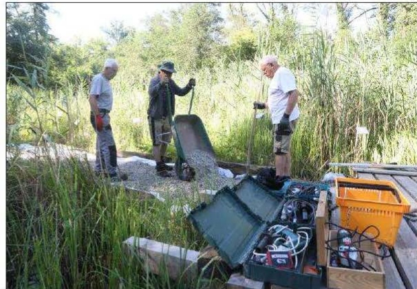
Le gros chantier du moment pour les Bras cassés, c'est la rénovation du sentier des mares. Les bénévoles apportent la touche finale à la reconstruction du chemin. Photo l'Alsace
